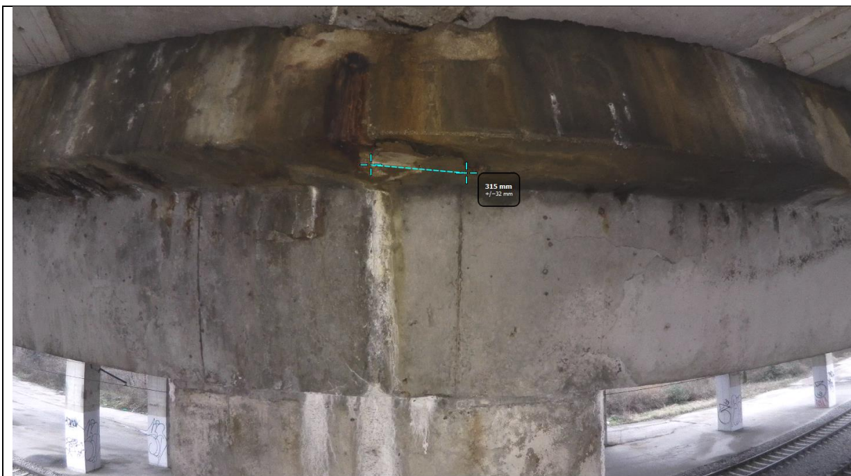
Obr. 3: Koroze výztuže úložného prahu opěry
