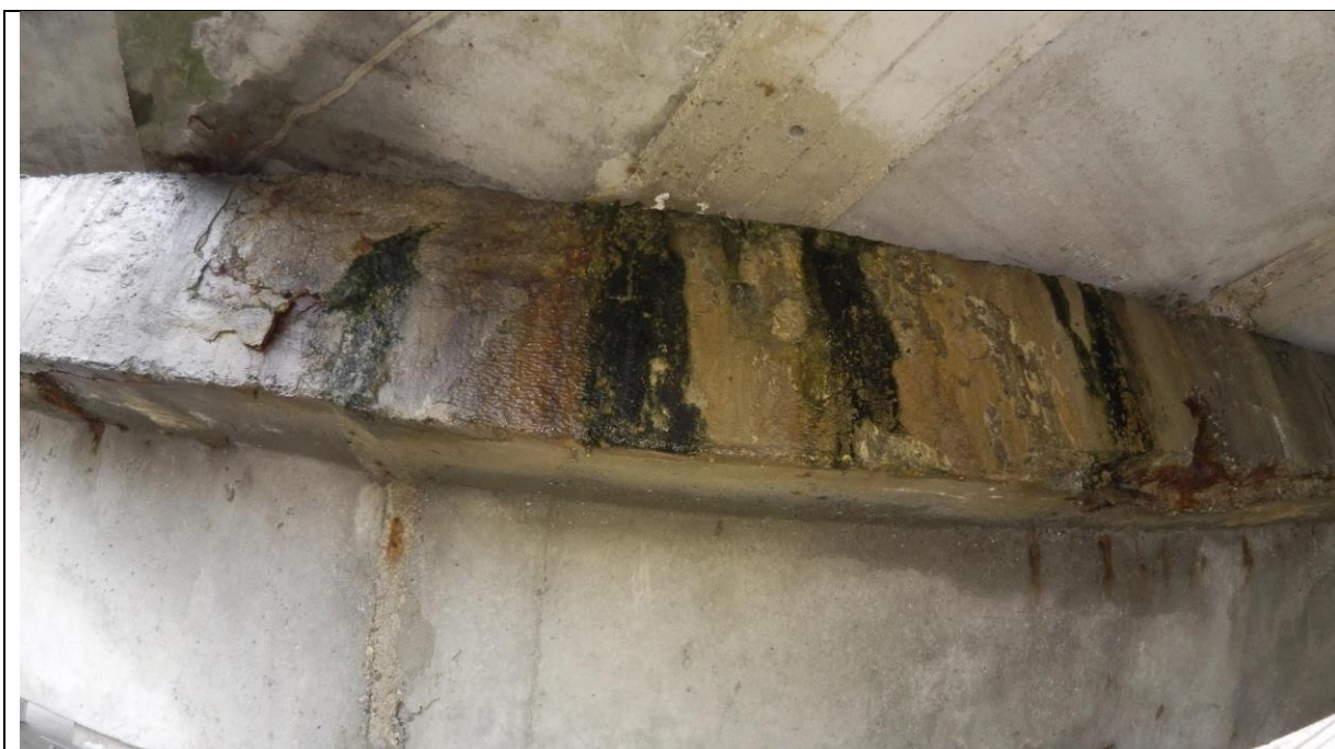
Obr. 4: Zatékání vody po úložném prahu opěry
