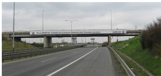
Obr. 1 Pohled na sledovaný most od jihu (ve směru od Lahovic k Ruzyni) – stav v listopadu 2014.
