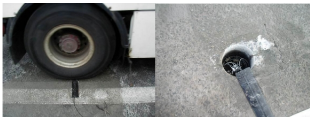
Obr. 2 Měření ovalizace na úseku dálnice RN4 [4].
