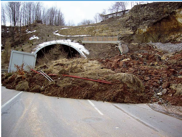
Obr. 2 Zřícení svahu u tunelu Hřebeč.
