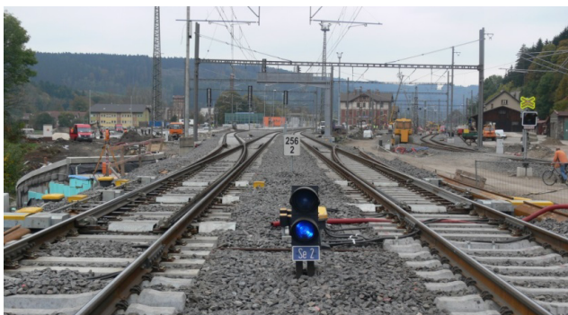
Obr. 1 Pohled na výhybky č. 7 (vlevo) a 8 (vpravo) ve zkušebním úseku v žst. Ústí nad Orlicí.
