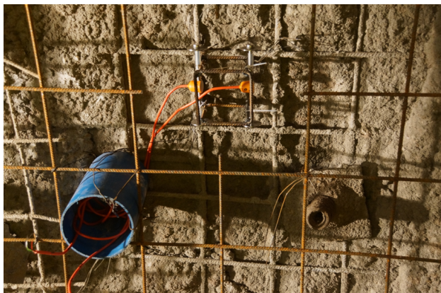
Obr. 1 Osazené extenzometry – tunel Sudoměřice.
