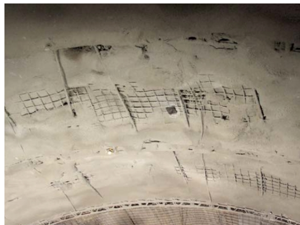
Obr. 1 Ukázka špatně provedeného nástřiku [4].
