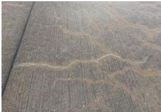
Obr. 1 Příklad napadení CB krytu vozovky.
