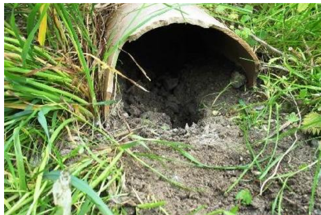
Obr. 4 Zanesený výtok z drenáže.
