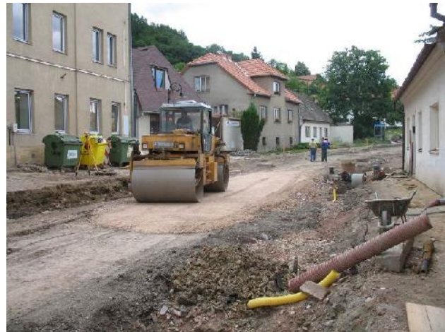
Obr. 1 Obtíže p í ešení drenáží p í rekonstrukci vozovky.
