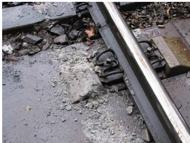
Obr. 1 Poškozená PJD od vykolejeného vozidla.
