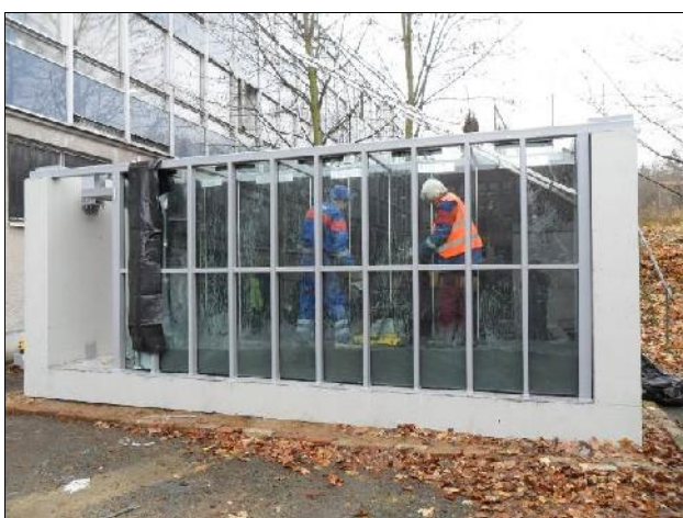
Obr. 3 Pln ní základní ásti zkušebního za ízení zeminou (pískem).
