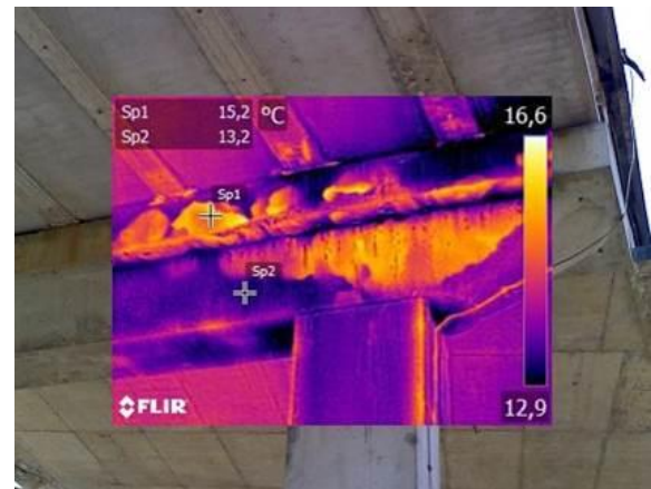
Obr. 2 Měření na most – delaminace krycí betonové vrstvy výztuže (na termogramu žlutá)
