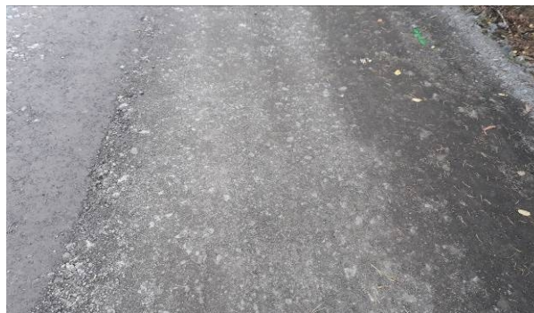
Obr. 1-3 Provedené nové podkladní vrstvy recyklací za studena s aplikací aktivovaného fluidního popílku
