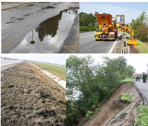
Obr. 3 Fotografie demonstrující poruchy odvodnění na různých částech pozemní komunikace - vozovka (vlevo), nepevná krajnice (vpravo), svah - násyp, rostlý terén (dole)
