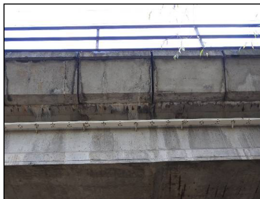
Obr. 1 Zatékání ve spárách konzoly
